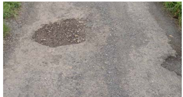
写真-2 凹凸のある状態で硬化した切削材表層の状況
