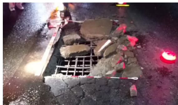
写真-1 コンクリート床版の抜け落ち事例
