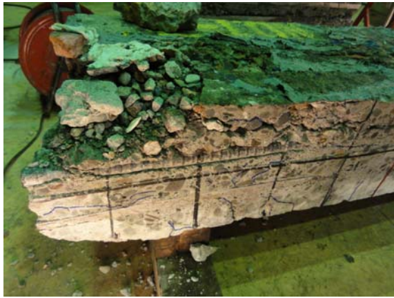
(a)No.1 (貫通ひびわれ有り)
