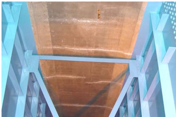
写真-2 1方向のみのひびわれで漏水・遊離石灰を生じた床版
