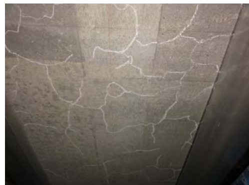
(b) No. 25 (貫通ひびわれ無し)
