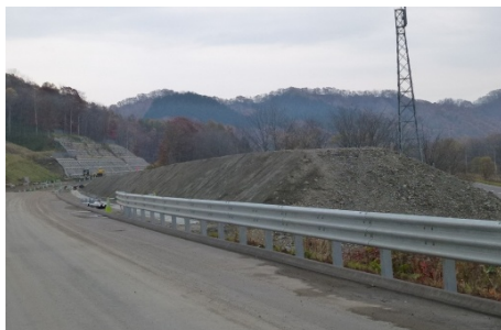
図-11 思わぬ支障となった防護盛土
