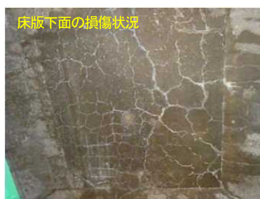
写真-1 床版損傷状況
