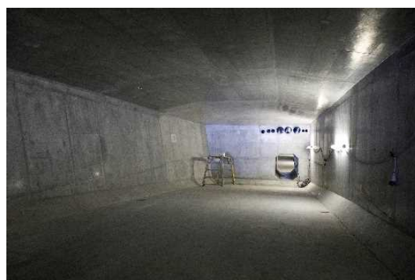
図-8 箱桁内簡易照明
