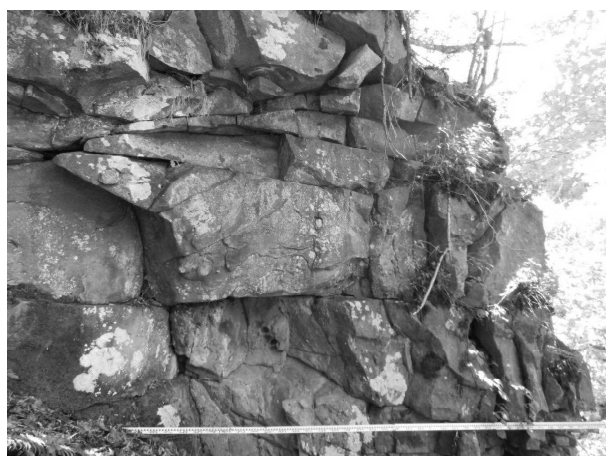
写真-2 露頭におけるゆるみ部の状況
