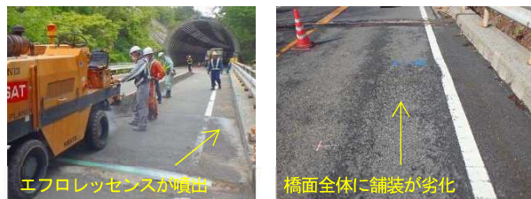
写真-4 応急復旧箇所後の再劣化状況
