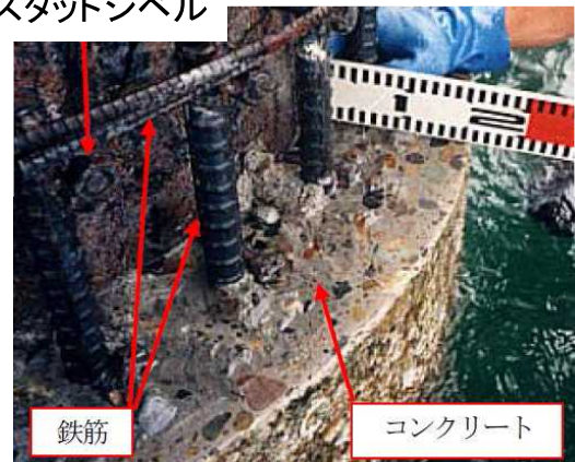
図-5 コンクリート被覆 (No. 18 : 30年)
