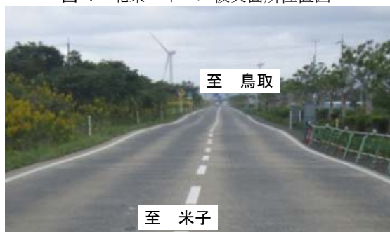
写真-1 CRCPのうねり
