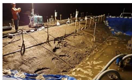
写真-4 外水位低下後に見られた川表法面の変状
