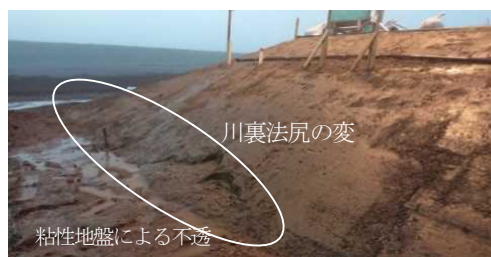
写真-3 降雨による川裏法尻の変状（現地試験）
