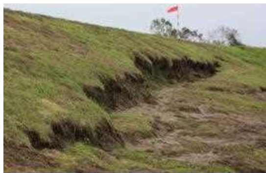
写真-1 釧路川で発生した堤防法面の被災（平成28年8月）
