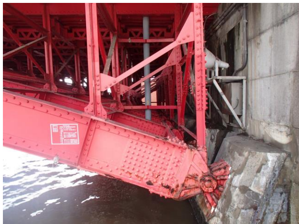
図-2 アーチリブ腐食状況
