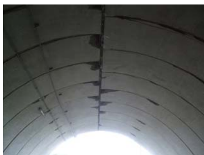
写真-2 ヒンジ部の損傷（その1）
