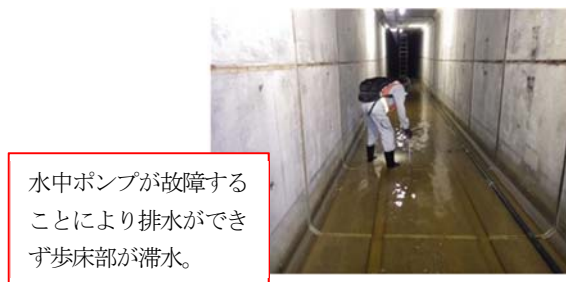
写真-2 共同溝付帯設備の不具合状況
