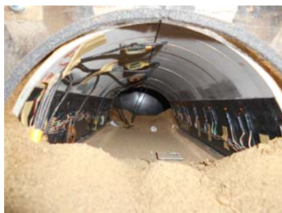
写真-12 CASE-2 加振後の内部状況
