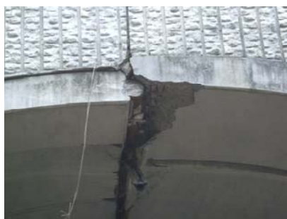
写真-3 ヒンジ部の損傷（その2）
