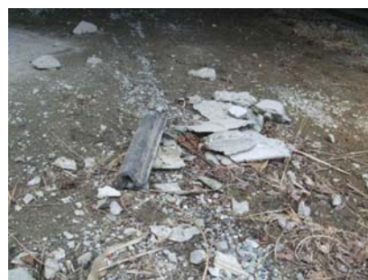
写真-4 落下したコンクリート片
