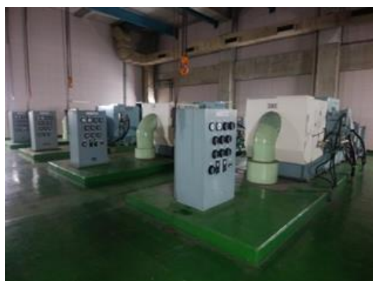
図-2 送風機の外観
