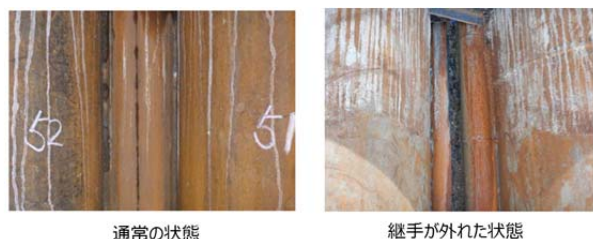
図-15 継手の変状
