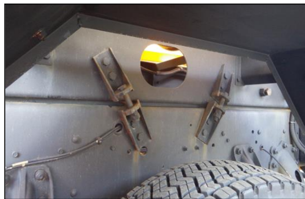
図-3 塗料A シャシフレーム外側状況
