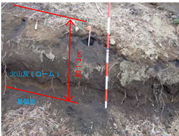
図-4 被災斜面の露頭状況写真
