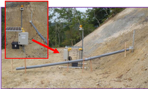
写真-14 伸縮計とサイレン装置
