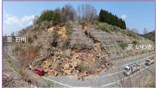
写真-3 既設アンカーが破断した状況 (図-3 ②)
