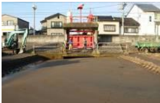
写真1 H20.12月閉塞した天王川排水樋管状況
