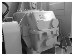
写真-5 動力切替装置
