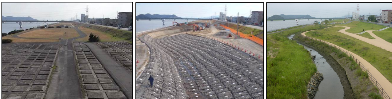
写真4 コンクリート撤去材再利用の施工前（左）、施工中（中）と施工後（右）
