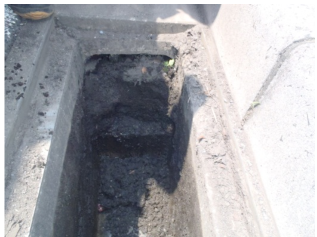
写真-4 排水施設（街渠）の塵埃堆積状況
