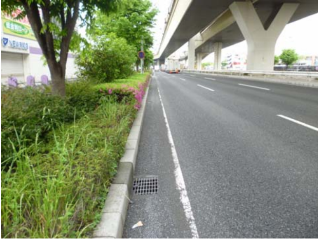
写真-5 飛散骨材の路肩堆積状況
