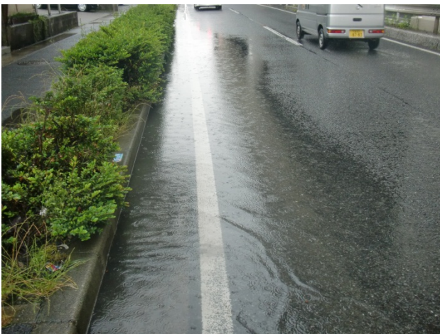
写真-2 水溜まり発生状況（2014年6月10日）
