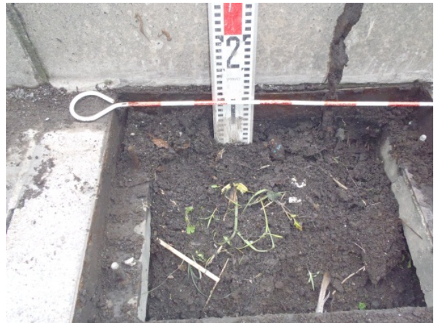
写真-3 排水施設（柵）の塵埃堆積状況
