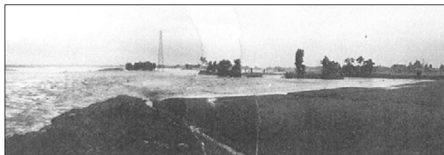
③南島堤護岸の破堤状況
