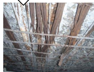
写真-2 第1径間の破断状況
