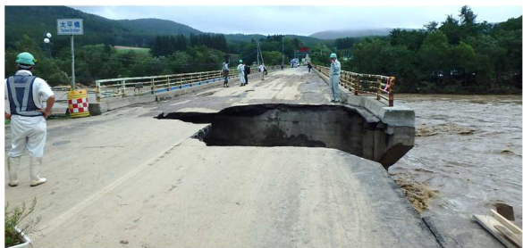
図-4 太平橋観測状況：橋の損壊（8月31日6時頃）
