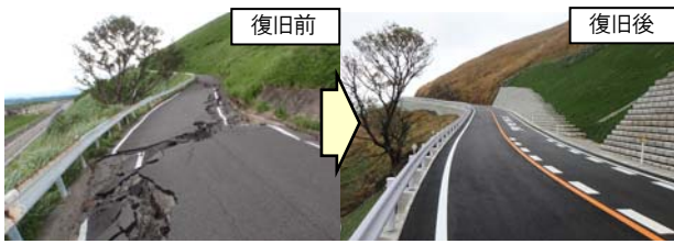
図-3 旧道迂回路の被災および復旧状況
