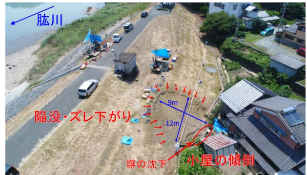
図-4 堤防裏のり面の陥没・ズレ下がり状況全景
