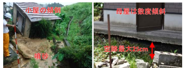
図-5 左：小屋の傾倒・噴砂状況 右：母屋の被災状況
