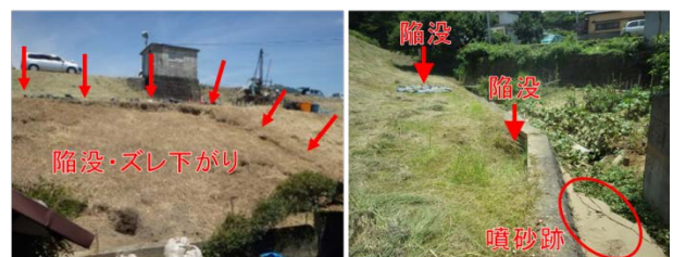
図-6 左：法面変状状況 右：上流側被災状況
