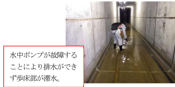
写真-2 共同溝付帯設備の不具合状況
