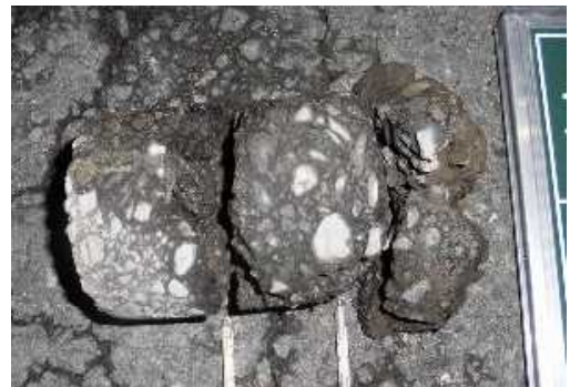
写真-3 コア写真 (ひび割れ部)
