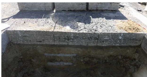
写真-6 アスファルト舗装損傷状況
