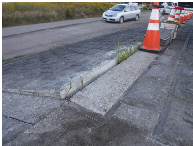
図-1 浮き上がった護岸ブロック(隣接区画)
