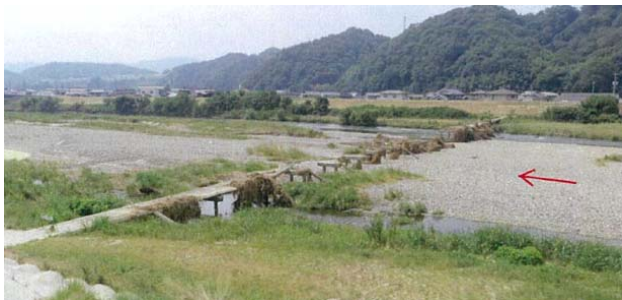
図5 水位低下後の潜水橋（本泉寺橋）
