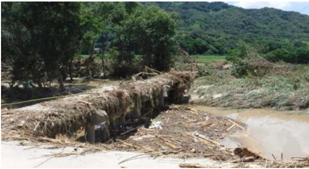
図4 被災直後の潜水橋（谷橋）
