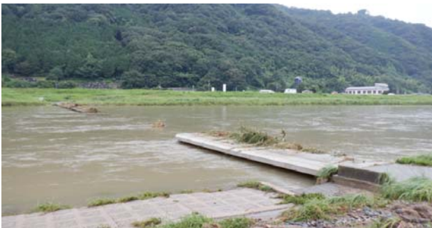
図12 下山守橋流失直後の様子（令和3年8月16日）
