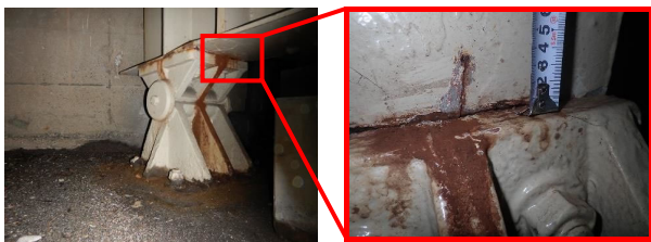
写真-6 主桁亀裂：下フランジ下面
