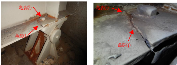
写真-7 亀裂①、②の状況
