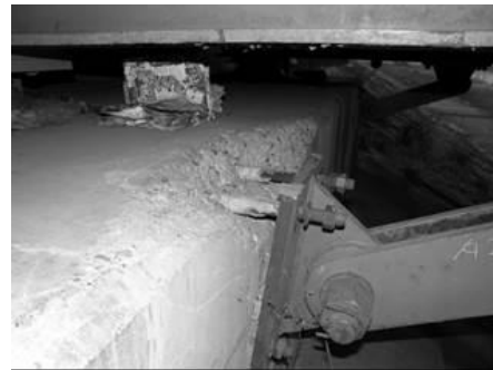
写真-1 縁端付近に取り付けられた落橋防止構造の取付部の損傷（アンカーの引き抜き） 5)
