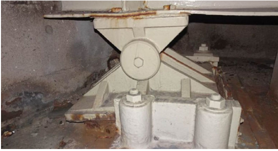
写真-2 支承損傷状況
