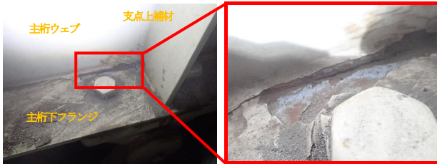
写真-5 主桁亀裂：支承中心より胸壁側
