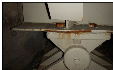
写真-10 ソールプレート未設置状況
