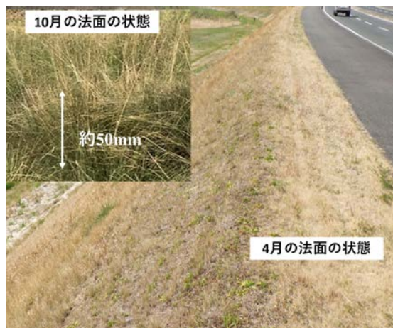
図-14 図-13の結果に示す法面の極性繁茂状況
