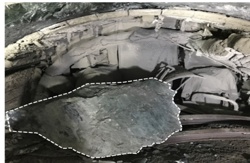
写真-1 肌落ち状況
