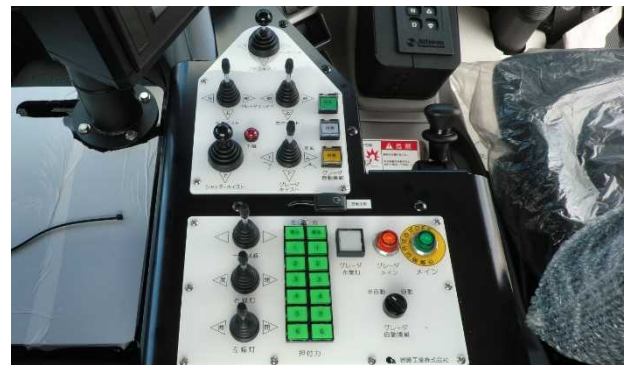
写真-1 作業装置の手動操作パネル
