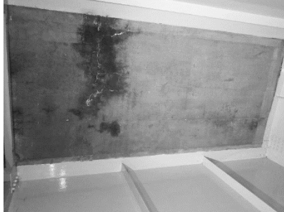
(b)点検技術者によって二方向と評価されたひび割れ 写真-1 方向性の判断が難しいと考えられる事例
