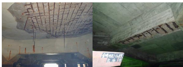
写真-3 上部工(床版下面)の鉄筋露出状況
