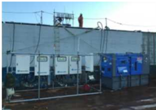
図-18 システム機材設置状況
