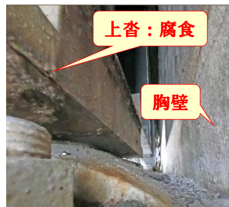
写真-6 上沓の腐食
