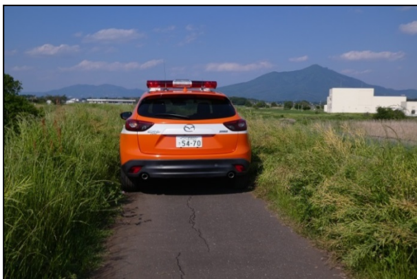
図-3 堤防天端の法肩における雑草繁茂状況
