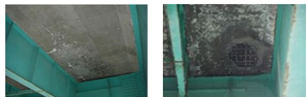
(a)前回の定期点検時 (b)床版下面抜け落ち時 写真-2 床版下面の抜け落ち事例
