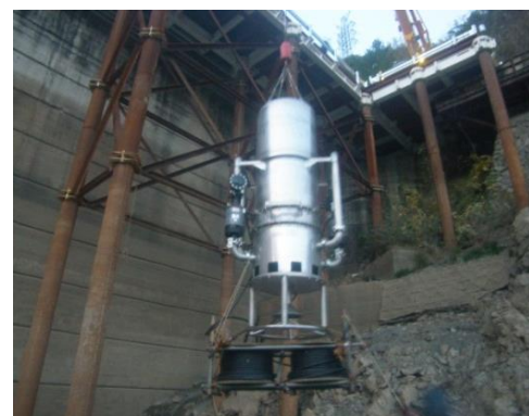
写真-3 高濃度酸素水供給装置
