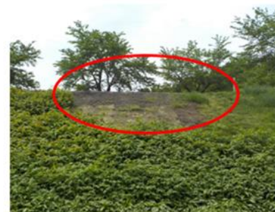
▲雪捨て場占用後の法面損傷
