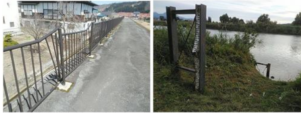
▲転落防止柵の損傷 (転落の危険性無し)
