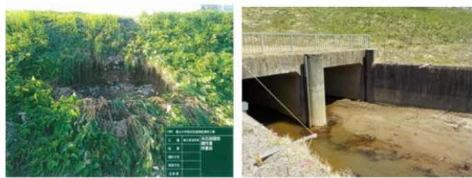
▲堤防本体の損傷
