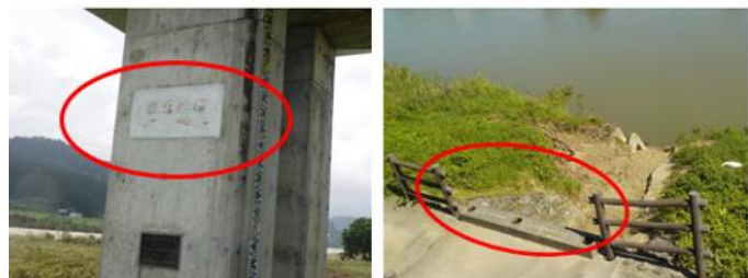
▲樋管の水位観測員退避水位の明示の劣化
