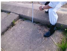
▲河川管理施設の軽微な損傷 (補修が必要な程ではない) ※継続監視が必要
