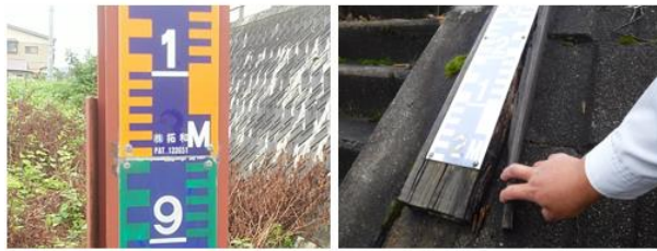
▲樋管の量水標の破損(読み取りに支障無し)
