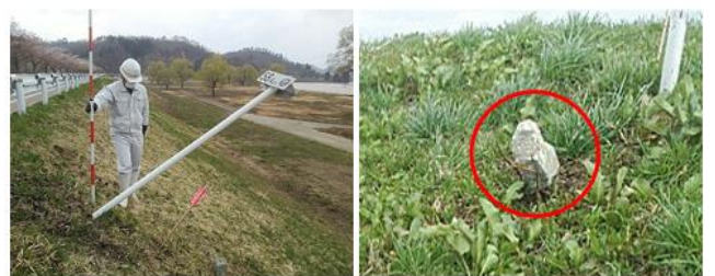
▲距離表示板や距離標杭の損傷
