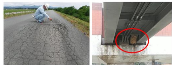
▲堤防天端の大きな損傷
