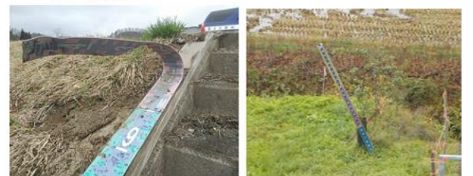
▲樋管の量水標の破損（読み取りに支障あり）
