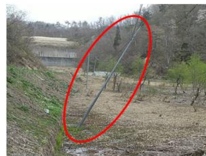
▲占用物件の損傷
