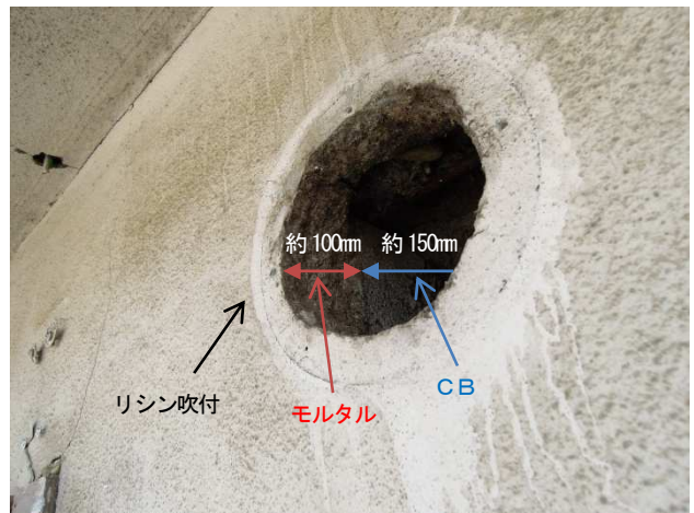
写真-2 モルタルとCBの断面状況（煙突穴）
