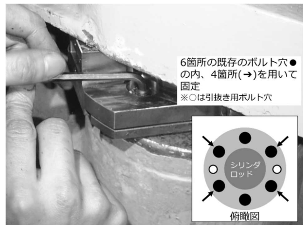
写真-7 固定に使用するボルト穴
