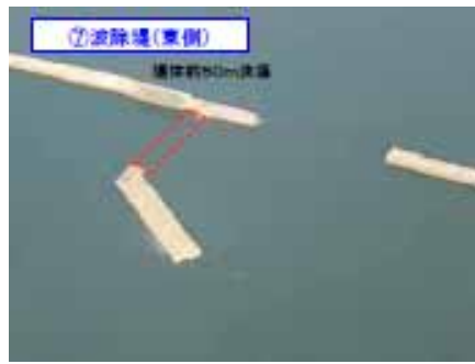
新湊地区波除堤の決壊
