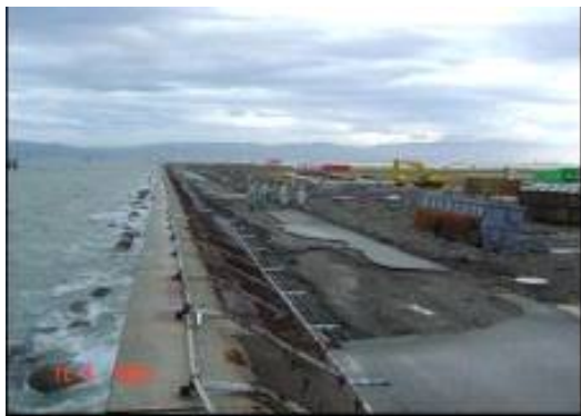
写真-1 越波により倒壊したフェンス
