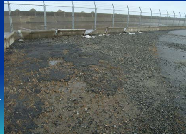
破損したL型擁壁
