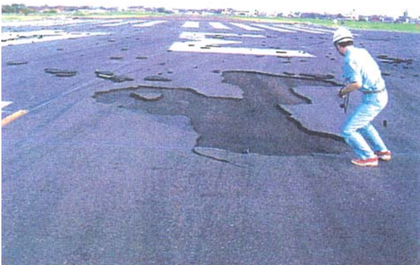
写真-1 ブリストリングによる舗装の損傷例
