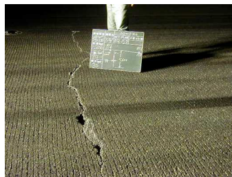
写真-3 滑走路のひび割れ
