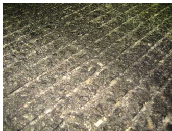
写真-2 滑走路表面の状況
