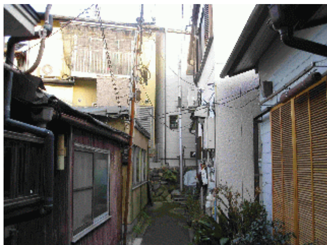
閉塞した空間と老朽建築物
