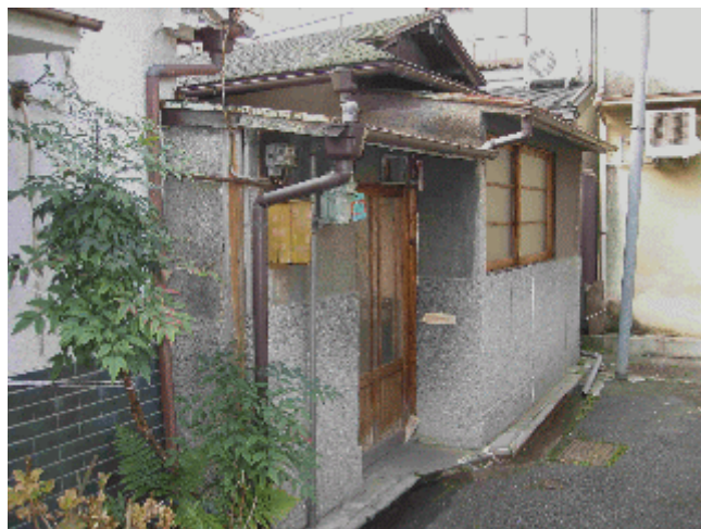
老朽化した住宅
