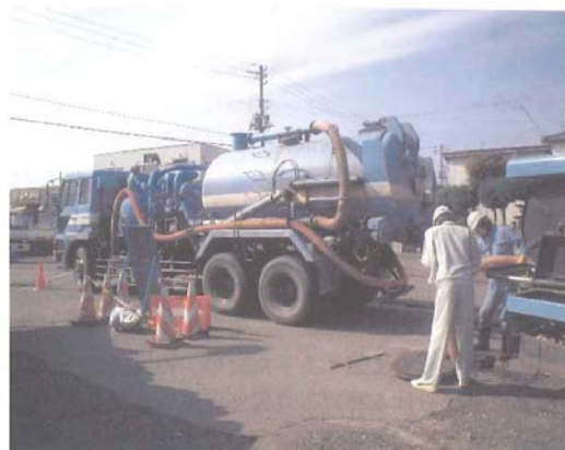
写真-2 溢水した下水を汚泥吸引車により汲み上げ
