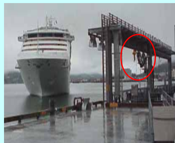
船舶への陸電供給設備
