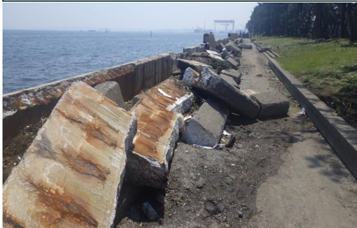
台風第15号により護岸が倒壊
