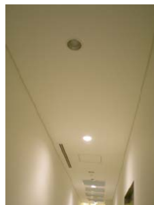
従業員通路照明の間引き
