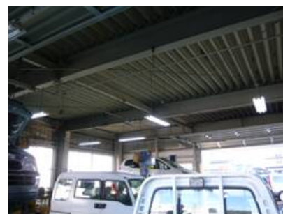
低い位置に吊るした照明設備
