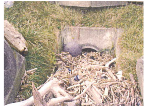
樋門出口に集積した漂着ゴミ
