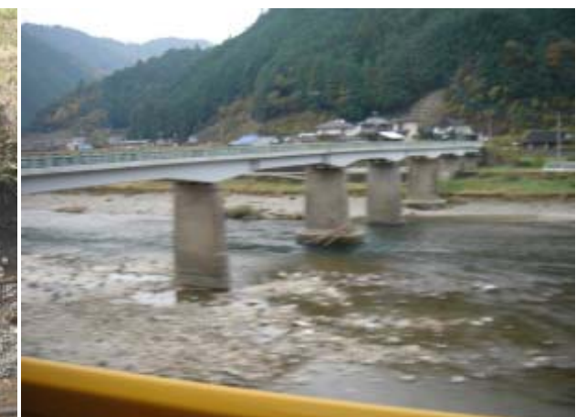
写真5 橋脚に堆積する流木（小瀬川）
