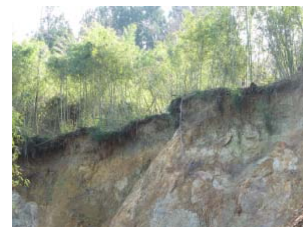
写真 3 ダム湖岸の斜面崩壊
