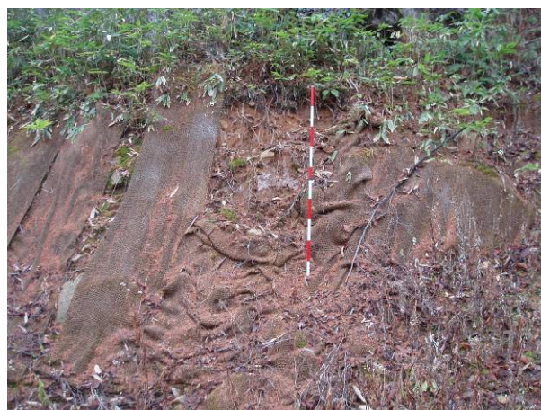
中御所治山作業道（1年経過） のり面の一部にヤシネットのはがれた箇 所が見られる
