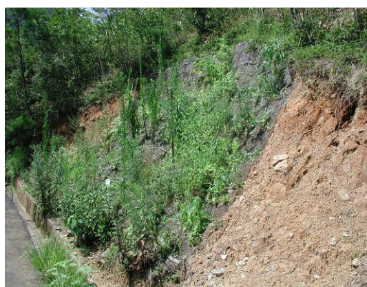
錦山保安林管理道 種子の導入を行わない工法による植生被覆の状況。 (施工後1年) 両側の未施工地と比較し、植生の成立が格段に多い。
