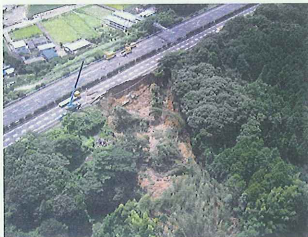
【駿河湾を震源とする地震(H21.8.11) による東名高速の被害状況】
