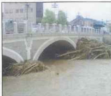
浅野川大橋の 流木堆積状況 (金沢市)
