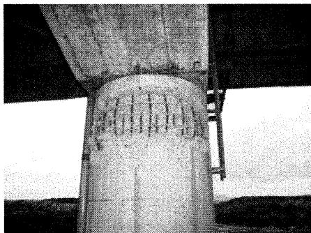
耐震対策をしていなかったため損傷を受けた例
