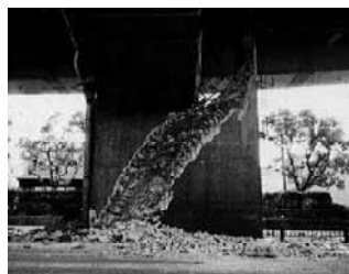
【兵庫県南部地震による橋脚の被災】
